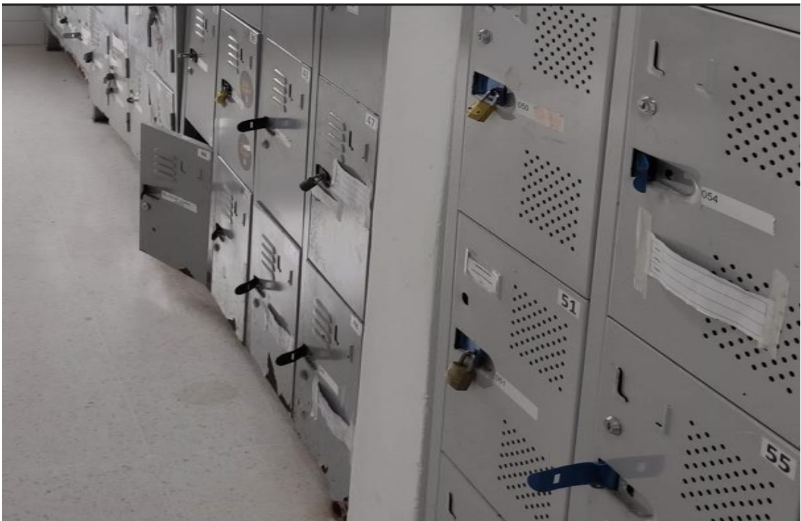
Imagem 13: Armários do Vestiário Masculino com desgaste e ferrugem
