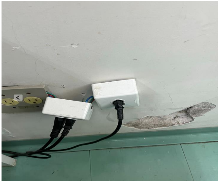
Imagem 33: Instalação elétrica precária 1
