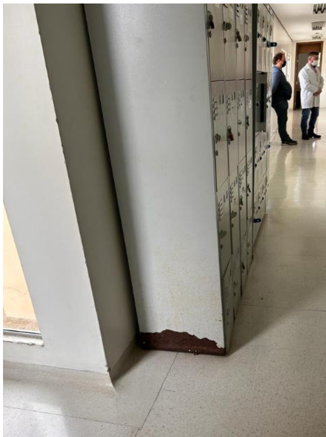
Imagem 17: Detalhe 2 da Situação dos Armários do Corredor
