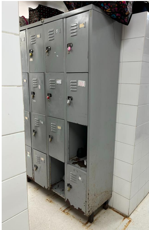
Imagem 20: Detalhe de ferrugem nos armários femininos
