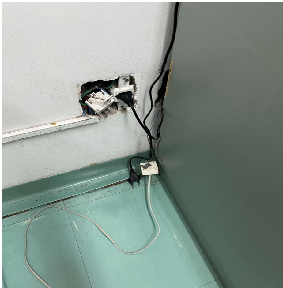
Imagem 34: Instalação elétrica precária 2
