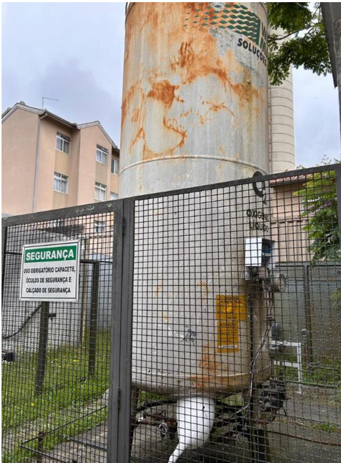
Imagem 55: Armazenamento externo de oxigênio
